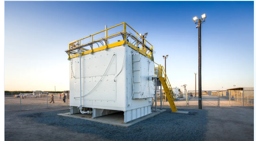
Bateria por Calor
