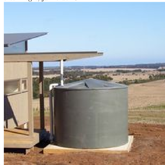
Cisterna para Água de Chuva, Austrália
